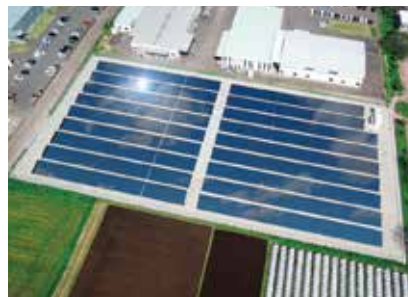
川南B地区 0.9ha 出力636kW
