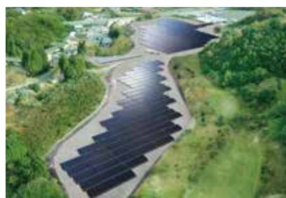
延岡市舞野町太陽光発電所 出力1,750kW
