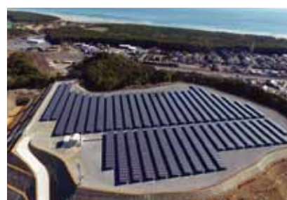
日向市財光寺太陽光発電所 出力1,000kw
