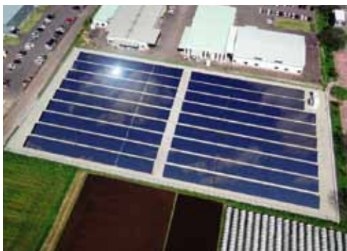
B地区 0.9ha 出力636kw
