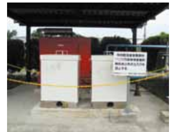
PCB機器保管状況
